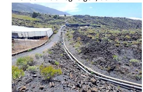
Hier enden Wasserleitung und Bananenanbau.
